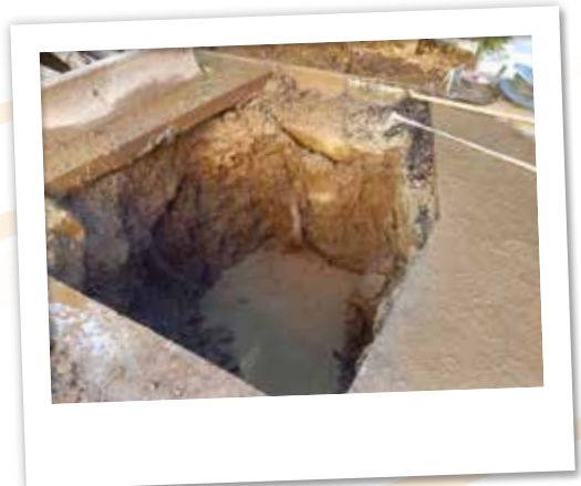
NOMBREUSES FUITES SUR LE RÉSEAU D'EAU POTABLE, ICI À LA MAISON DU ROY
